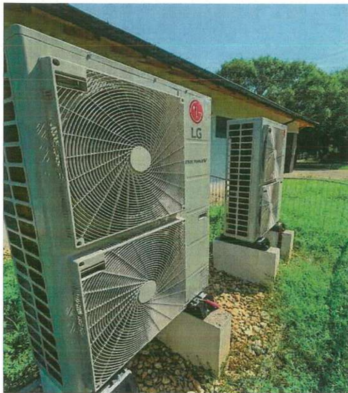
Levegő-víz hőszivattyú kültéri egység
