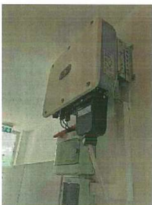
napelemes rendszerhez tartozó inverter
