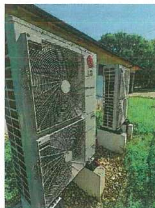
levegő-víz hőszivattyú kültéri egység
