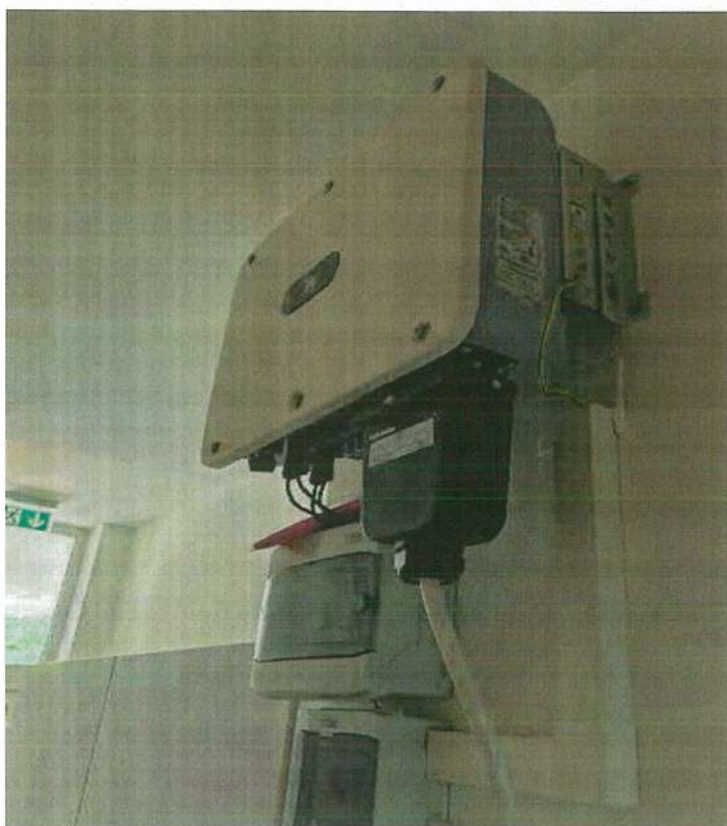
Napelemes rendszerhez tartozó inverter
