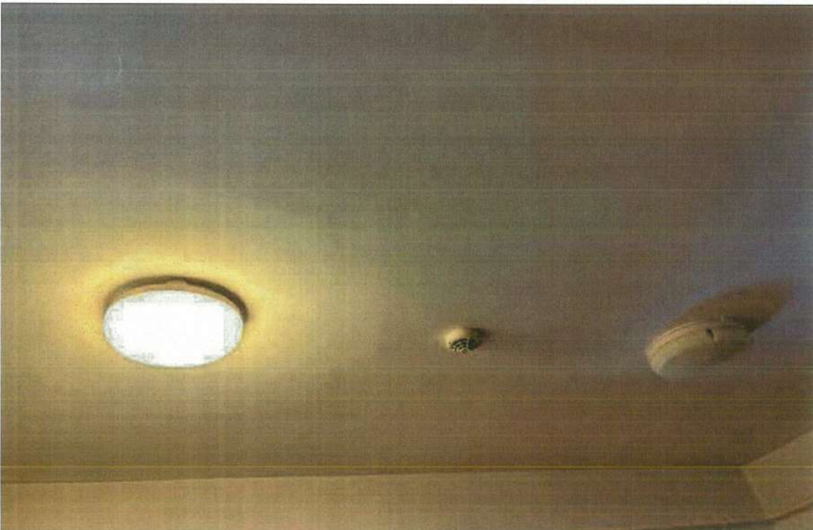
Jellemző világítás – LED fényforrások
