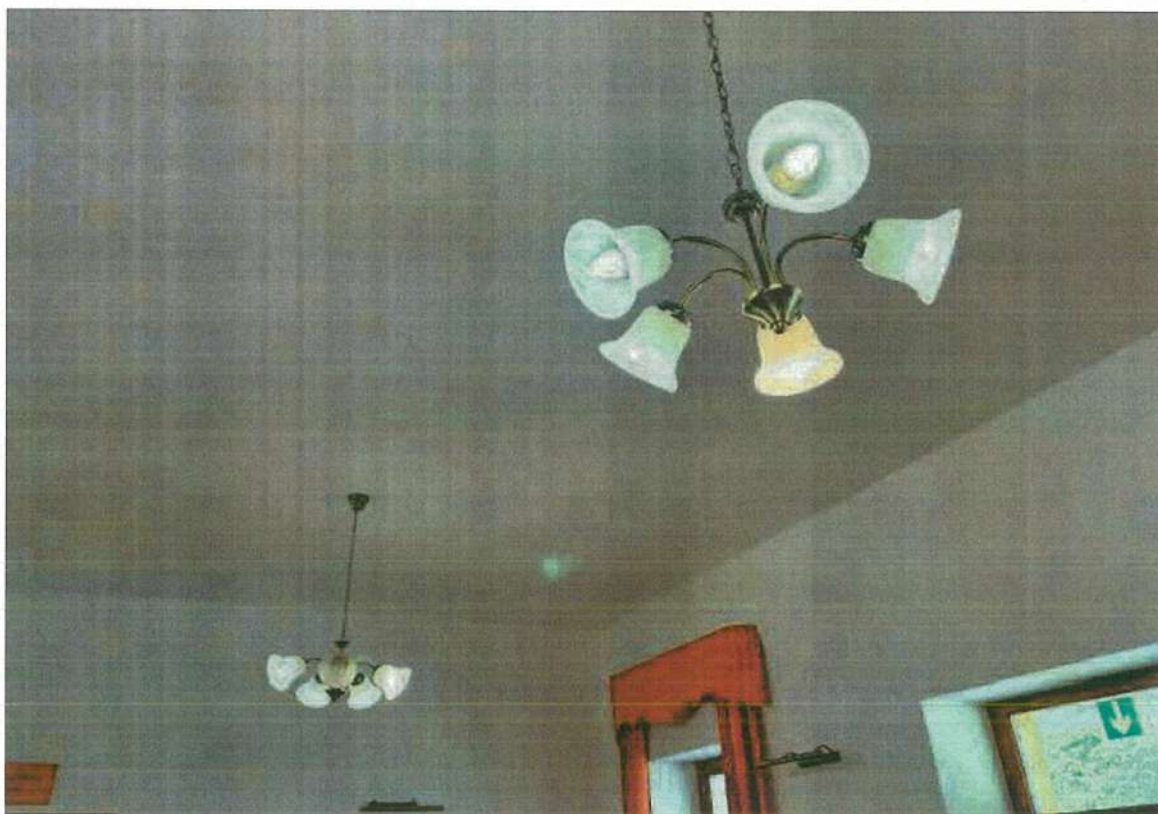
Jellemző világítás – LED fényforrások
