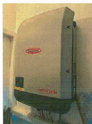
napelemes rendszerhez tartozó inverter
