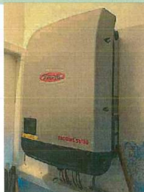
Megjegyzés: napelemes rendszerhez tartozó inverter
