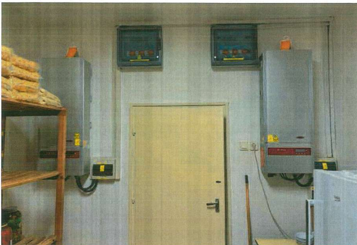
Napelemes rendszerhez tartozó inverter
