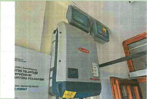
Megjegyzés: napelemes rendszerhez tartozó inverter
