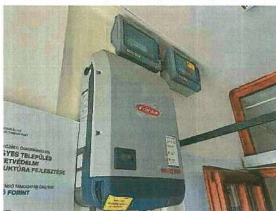
napelemes rendszerhez tartozó inverter
